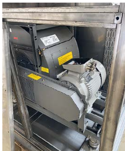
❖ Фото 5. Центробежный вентилятор в приточной камере
