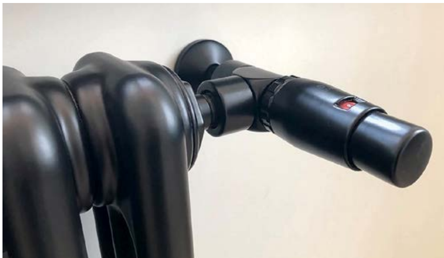
❖ Радиатор отопления с термостатическим комплектом Schlosser в гостиничном комплексе
