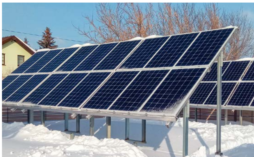
Готовые к работе солнечные модули на наземной конструкции
