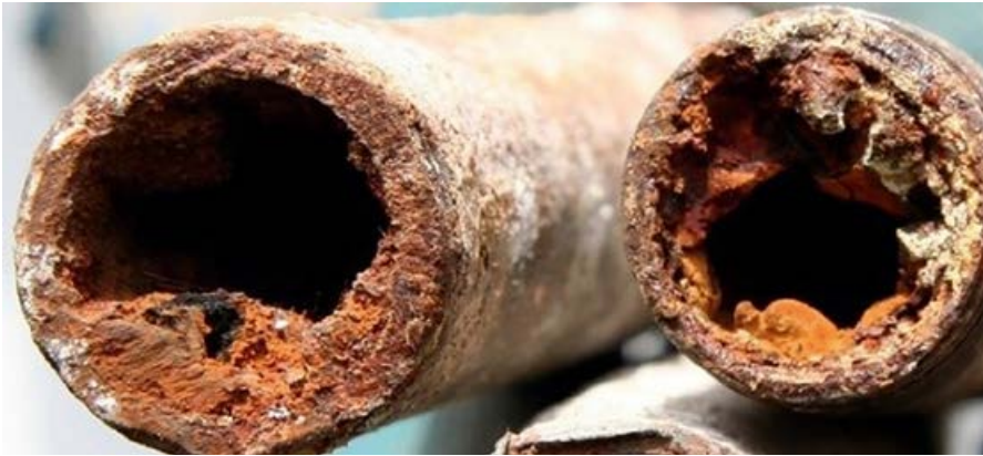
Рис. 1. Внутренняя коррозия водопроводных труб
