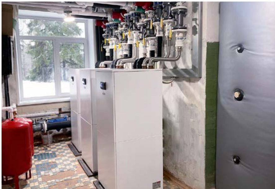
Здание школы (МБОУ «Житковская СОШ») в посёлке Житково Выборгского района Ленинградской области отапливается ГСТ с тремя тепловыми насосами Thermex Energy Pro 35 (112 кВт)
