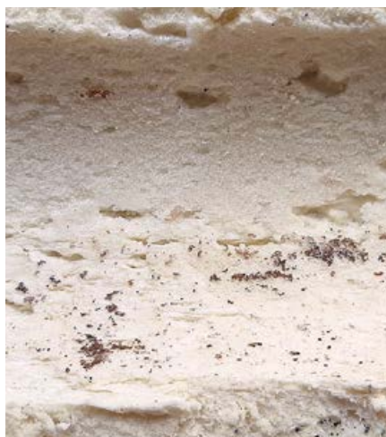
•• Фото 26. Следы ржавчины на ТИМ (гр. III)
