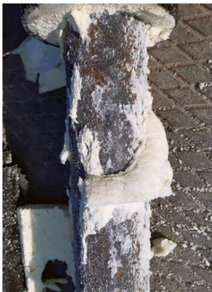
•• Фото 29. Следы ржавчины на трубе (гр. III)
