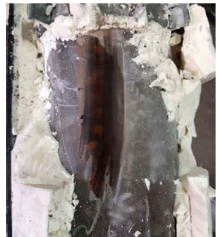
•• Фото 28. Следы ржавчины на трубе (гр. V)
