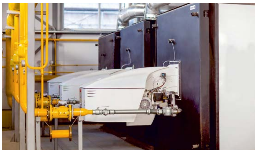
•• Стальные котлы серии CABK в киржачской котельной
