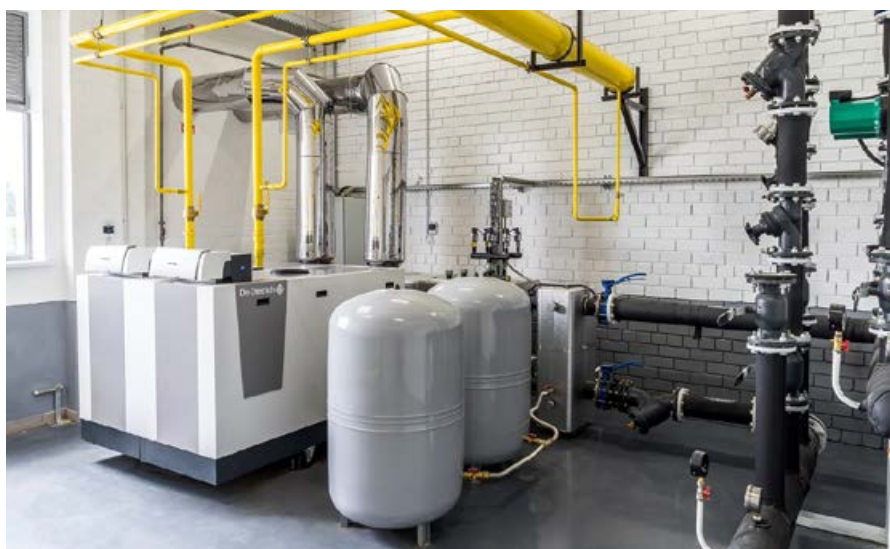
❖ Крышная котельная в городе Егорьевске (Московская область) с котлом С 630 Eco , оборудованном самой современной автоматикой Diematic Evolution
