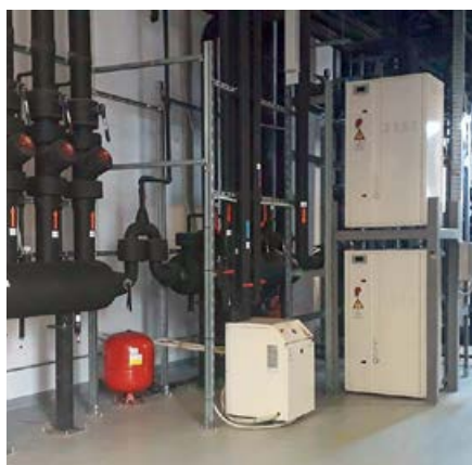
⚡ Инженерные системы центра ELI-NP
