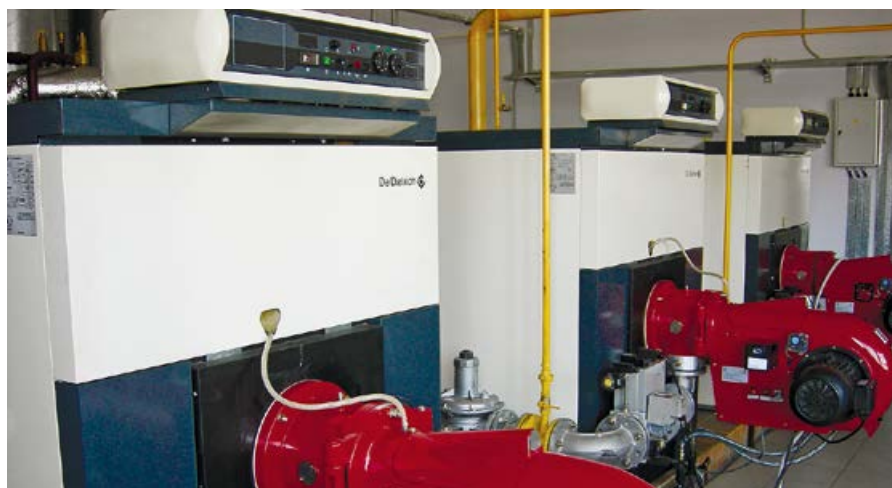
•• Котельная в Волгограде на основе чугунных котлов GT 530 с автоматикой Diematic-m3
