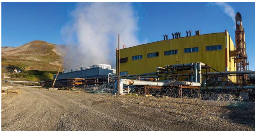
Мутновская ГеоЭС мощностью 50 МВт — крупнейшая геотермальная электростанция России
