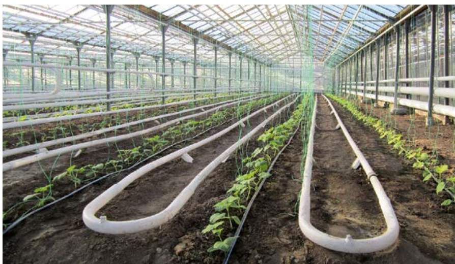
•• Геотермальное отопление почвы в тепличном комплексе в деревне Истебанья, Македония
