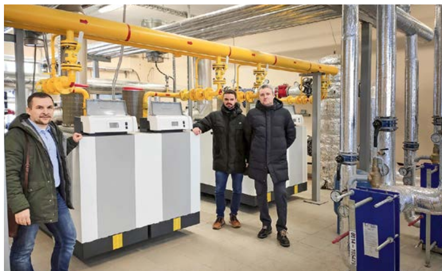
❖ Крышная котельная в Рязани на основе котлов С 630 Eco с автоматикой Diematic Evolution
