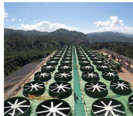
Geotермальная электростанция Geotérmica Platanares SA de CV мощностью 35 МВт в районе Платанарес [муниципалитет Ла-Юнион (La Unión), департамент Копан (Copán), Гондурас], возведённая компанией Ormat Technologies Inc.
