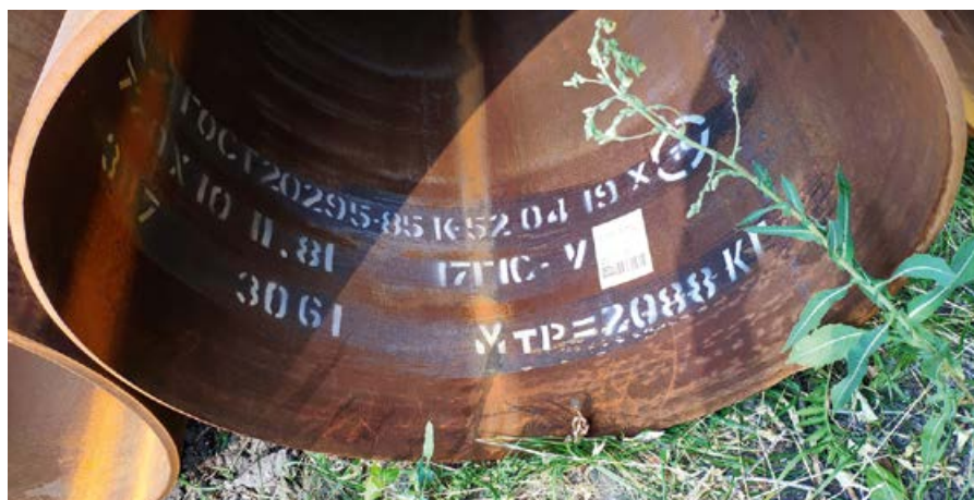
❖ Фото 3. Проверка заводского клейма на стальной трубе в ходе проведения входного контроля
