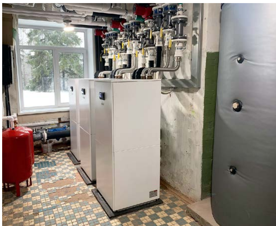
❖ Фото 3. Каскадная теплонасосная установка в МБОУ «Житковская СОШ»
