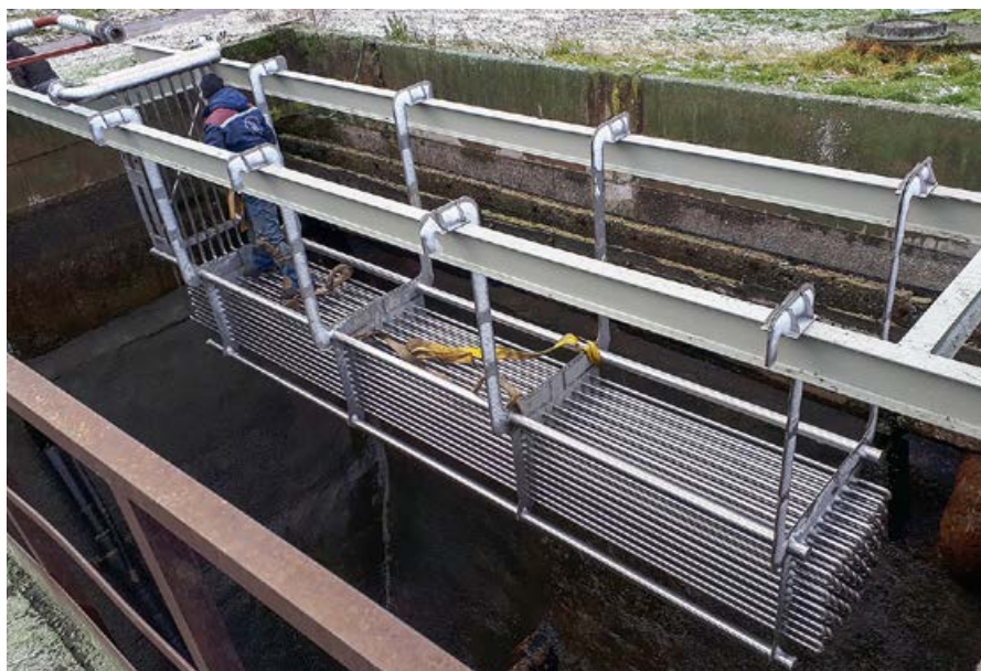
❖ Фото 5. Теплообменник для отбора тепла от сточных вод
