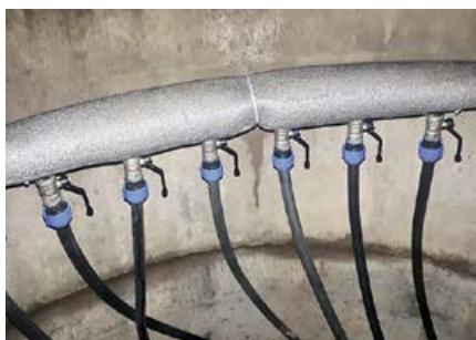
❖ Фото 6. Общий коллектор геотермального контура в обслуживаемом колодце
