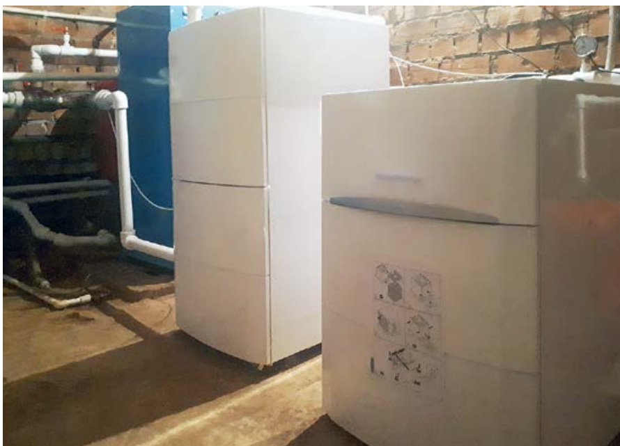
❖ Фото 8. Геотермальный тепловой насос De Dietrich GSHP 27 TR с буферным баком GT 200
