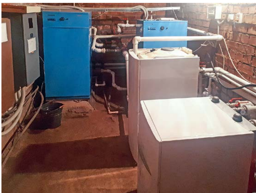
❖ Фото 2. Установка теплового насоса De Dietrich GSHP 27 TR в действующей котельной
