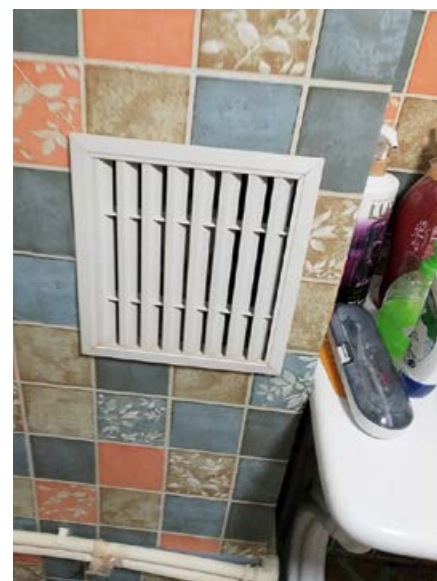
⌘ Фото 4. Вентиляционная решётка в ванной комнате квартиры жилого дома в Пекине. Через вентиляцию распространяются неприятные запахи из других квартир
