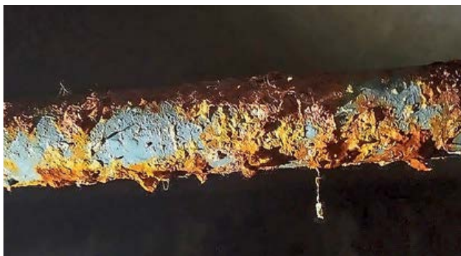
:: Рис. 1. Состояние повреждённой поверхностной коррозией водопроводной трубы в подвале жилого дома
