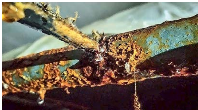
:: Рис. 2. Один из способов, применяемых для устранения сквозного отверстия ( свища ) в трубопроводе холодного водоснабжения
