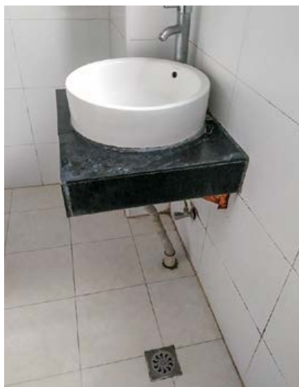
⌘ Фото 1. Ванная комната в отеле в Пекине с раковиной без сифона, негерметичной трубой канализации и сливом в полу без сифона
