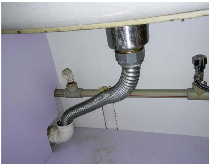
⌘ Фото 3. Гибкая сливная труба кухонной мойки без сифона, входящая в канализационную трубу без герметичного соединения, в типичной квартире в Пекине — китайской столице
