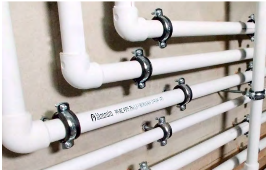
⊘ Полипропиленовые трубы Lammin®, смонтированные в системе водоснабжения
