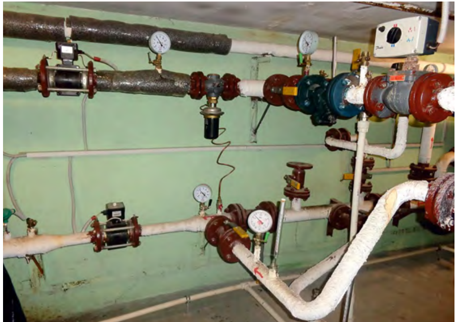
Рис. 1. Внешний вид ИТП после его реконструкции и оснащения средствами автоматизации
