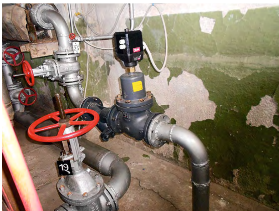
❖ Рис. 3. Регулирующий клапан Danfoss в помещении центрального теплового пункта (ЦТП)
