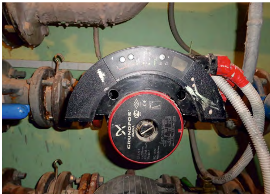
❖ Рис. 2. Насос Grundfos Magna, оснащённый частотно-регулируемым приводом (ЧРП) и панелью управления на корпусе насоса
