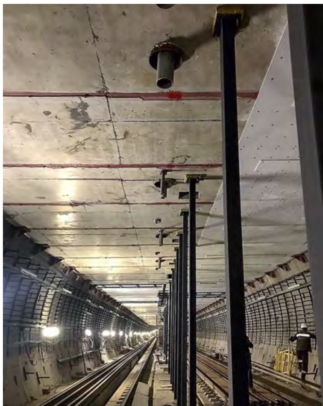
⌘ Опорные стойки напорных трубопроводов
