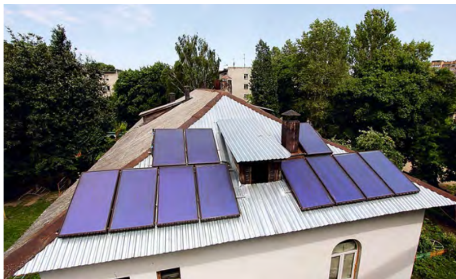
■ Солнечные коллекторы серии «Яsolar» на крыше частного дома
