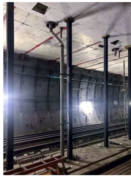
⚡ Напорный трубопровод от насоса
