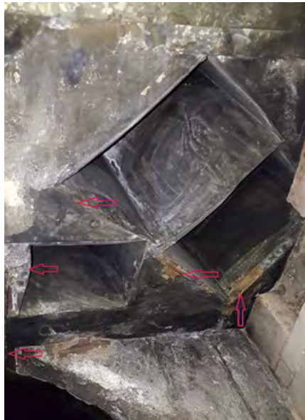
•• Фото 4. Помещение калориферной. Коррозия и деформация воздухопроводов системы ВО
