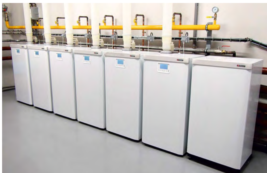
❖❖ Каскадная котельная на базе напольных газовых конденсационных котлов Condensation
