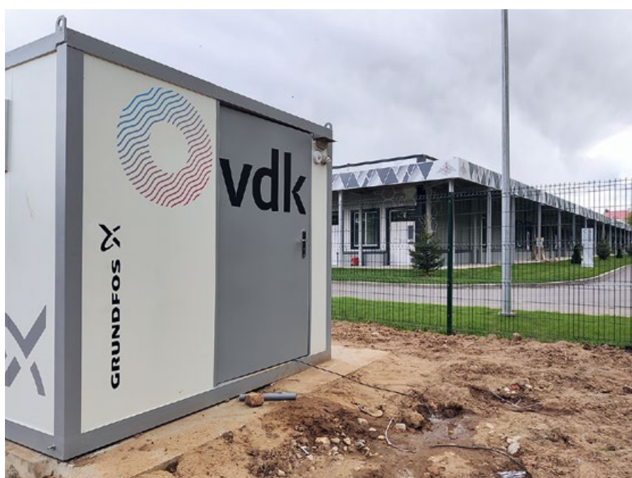
●● Мобильный блок-контейнер с системой очистки стоков на базе оборудования Grundfos при военном госпитале в Подольске
