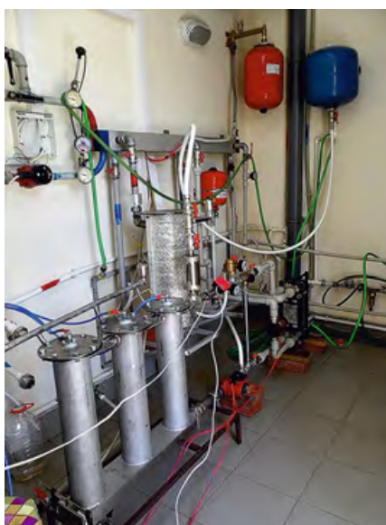
❖ Первый теплогенератор АТМ-Сочи, изготовленный и смонтированный в 2013 году
