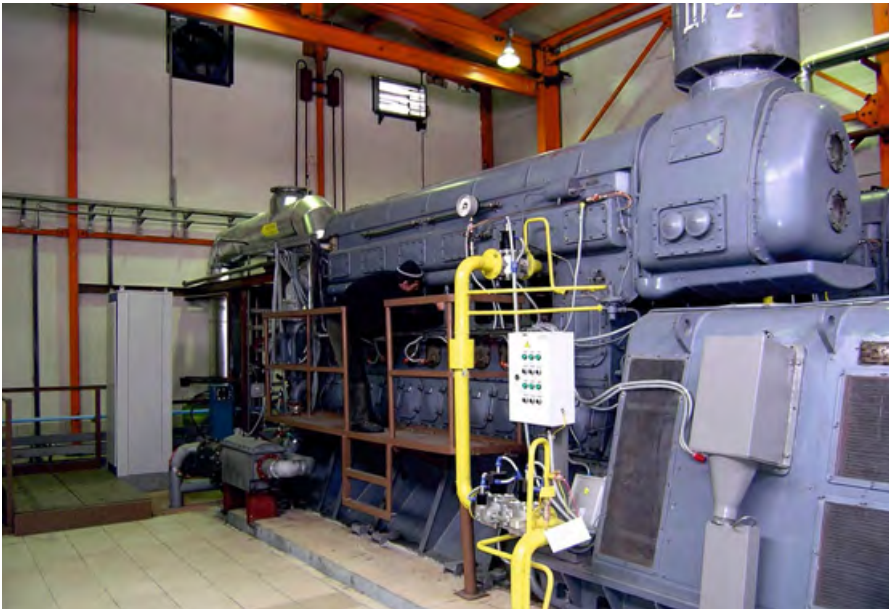
❖ Рис. 2. Газопоршневая электростанция 11ГД100 мощностью 1000 кВт на Валуйском комбинате растительных масел (Белгородская область)
