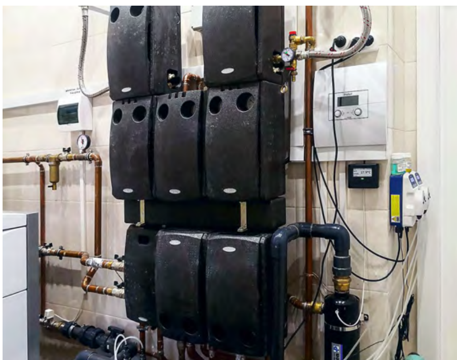
Элементы системы отопления
