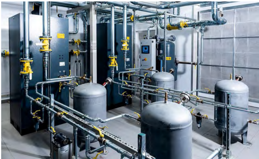
❖ С помощью инженерных систем Viega смонтировали сразу несколько систем на объекте
