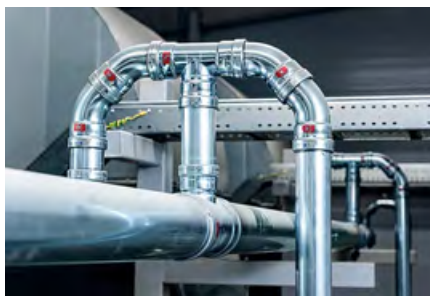
❖ Систему пневмоснабжения цеха (сжатый воздух и азот) смонтировали с помощью продукции Viega Prestabo Labs-free
