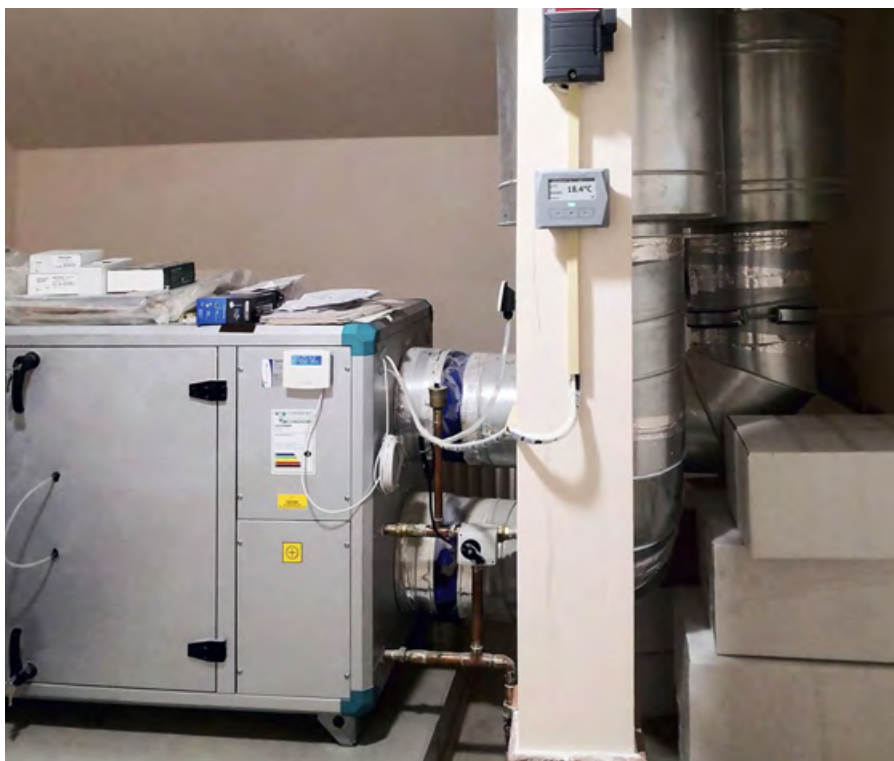
❖ Приточно-вытяжная установка системы вентиляции с рекуператором тепла
