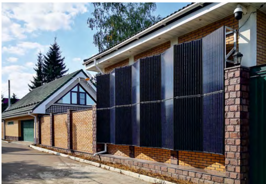
•• Вертикально установленные солнечные панели энергоэффективного эко-дома
