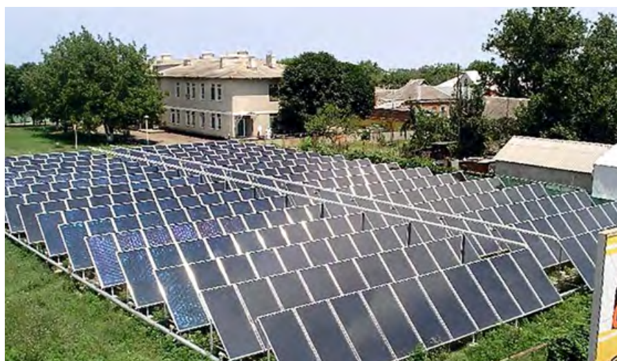
❖ РИС. 3. Гелиоустановка больничного комплекса в Усть-Лабинске
