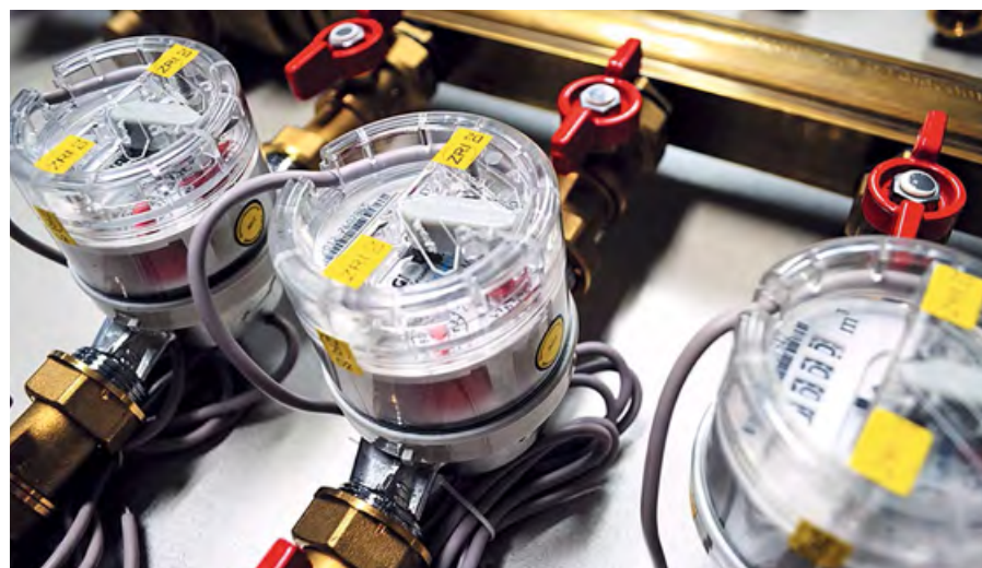
Отводы узла с теплосчётчиками
