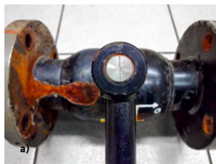
❖ Рис. 5. Коррозия элементов стальных шаровых кранов (а — Ду65; б — Ду80)
