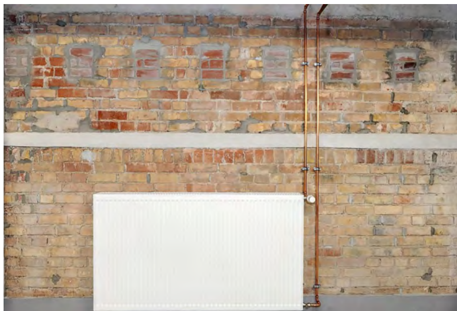
⚡ Пресс-система Viega Profipress использована для монтажа медных трубопроводов и радиаторов системы отопления в нижней части здания
