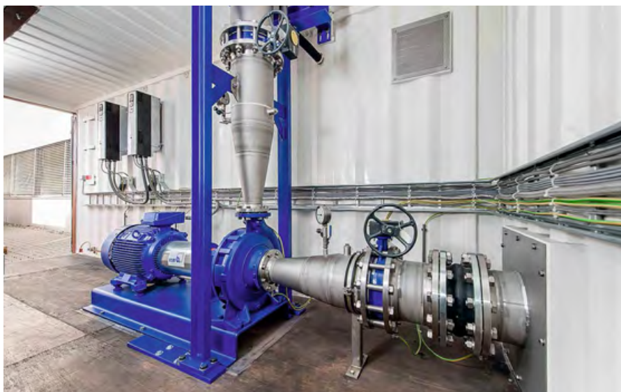
:: Рис. 2. Энергоблок в контейнерном исполнении с насосом в турбинном режиме
