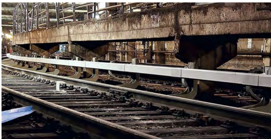
❖ Биметаллический контактный рельс RENAУ установлен в метро Санкт-Петербурга
