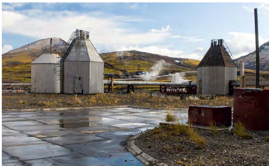
•• Сквazhinные укрытия на территории геотермальной станции Мутновская
