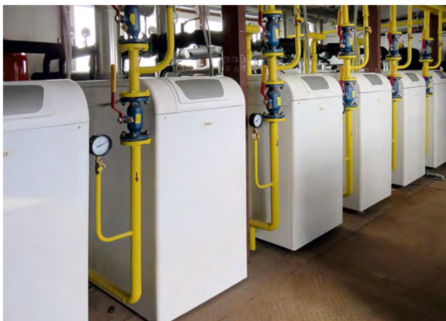
Напольные конденсационные котлы Power NT в каскадной котельной ТЦ «Крона Парк»
