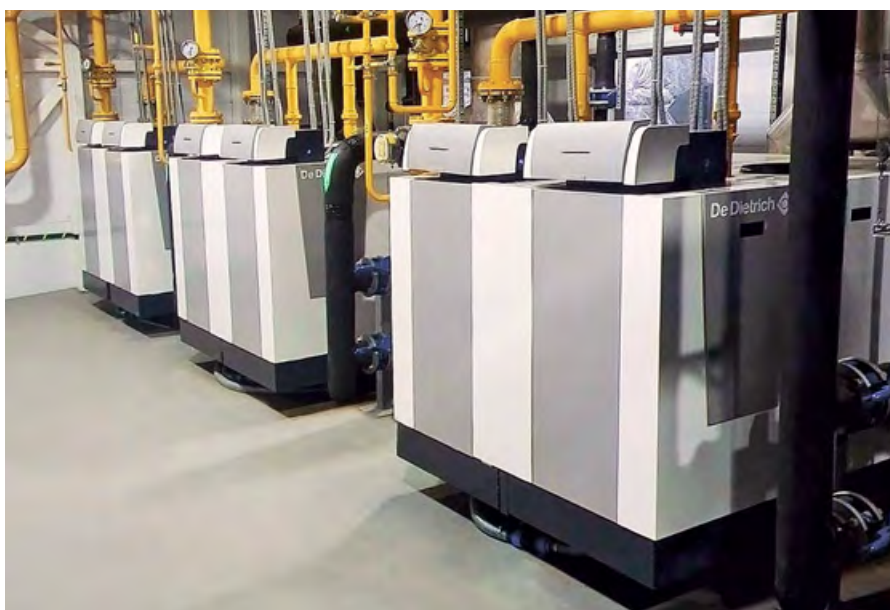
•• Конденсационные газовые котельные установки De Dietrich C 630 в крышной котельной
