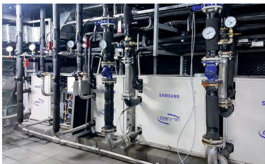
❖ Рис. 3. Наружные блоки DVM S Water установлены в техническом помещении цокольного этажа железнодорожного вокзала в городе Астане
