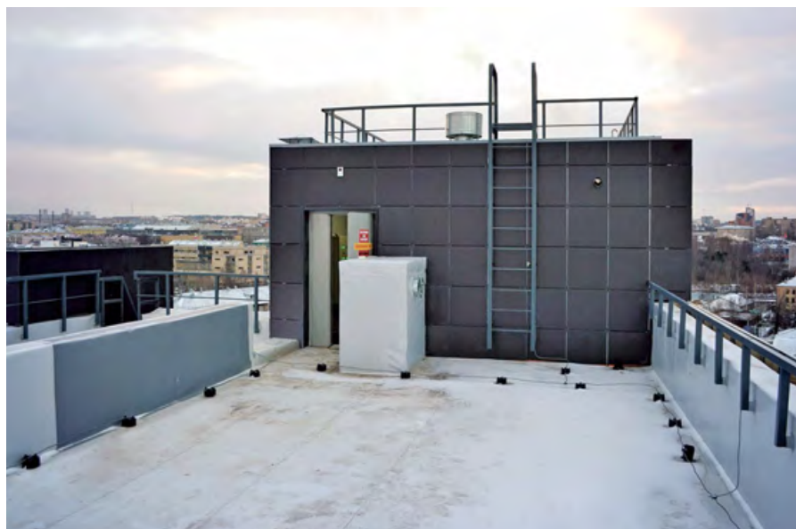
❖ Крышная котельная мощностью 1200 кВт
