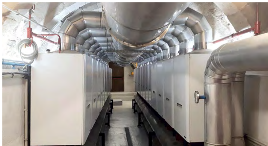
●● Модульная котельная FRISQUET в замке Шантийи — 28 котлов мощностью по 45 кВт каждый
