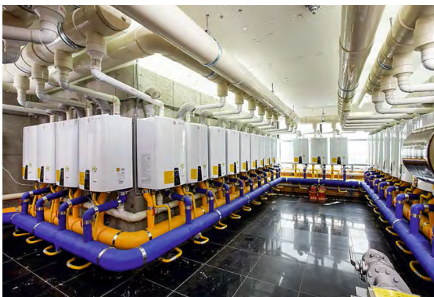
● 32 конденсационных газовых котла Navien в режиме отопления развивают мощность потребления до 1500 кВт, объединяясь в каскад одним универсальным модулем системы управления
