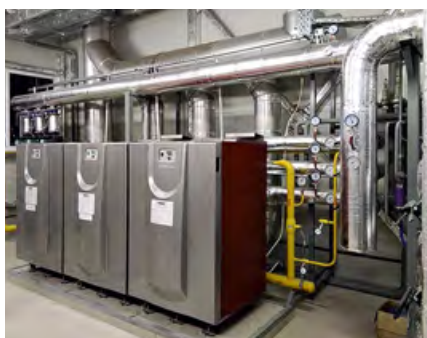
❖ Суперкомпактная котельная 2,7 МВт
