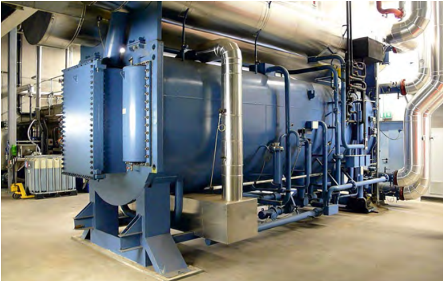
Пример абсорбционных технологий — абсорбционная холодильная машина
