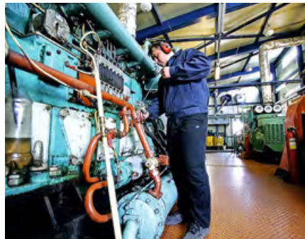
● ● Дизельная электростанция в Чукотском автономном округе
