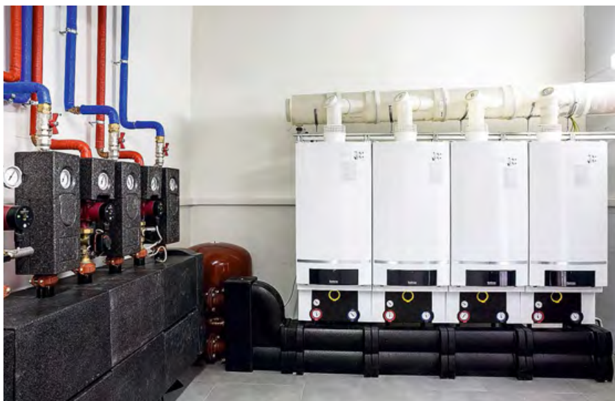
❖ Каскад газовых конденсационных котлов Buderus Logamax plus GB162
