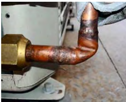
❖ Рис. 4. Залом трубопровода (снижение производительности, выход из строя компрессора)
