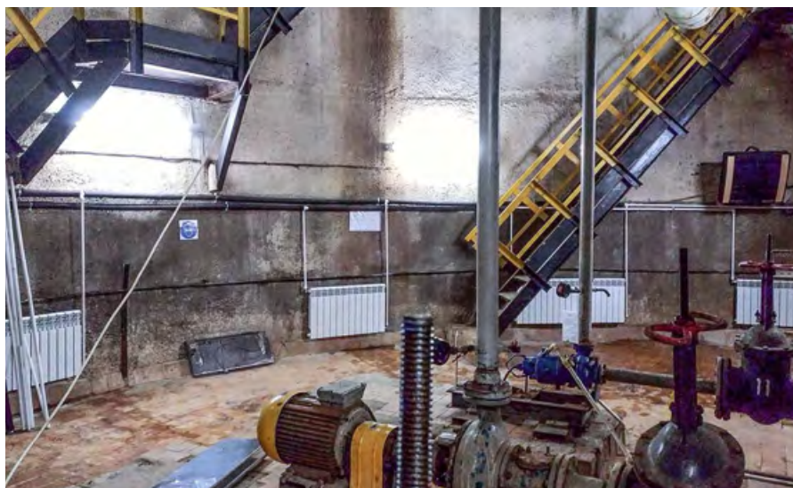
❖ Фото 1. Канализационная насосная станция №12 ЗАО «Челныводоканал»
