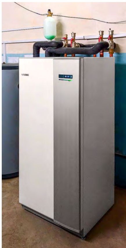
●● Фото 2. Тепловой насос, установленный на КНС-12 ЗАО «Челныводоканал»
