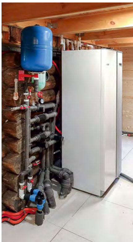
●● Фото 3. Инверторный тепловой насос, установленный в частном доме
