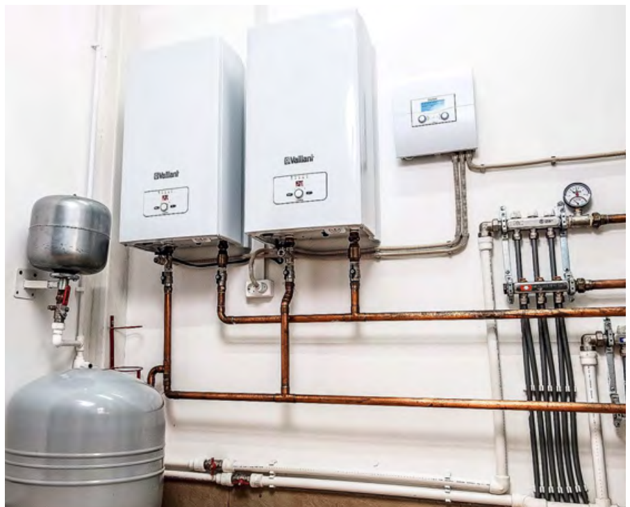
❖ Два электрических котла Vaillant eLoBLOCK в каскаде
