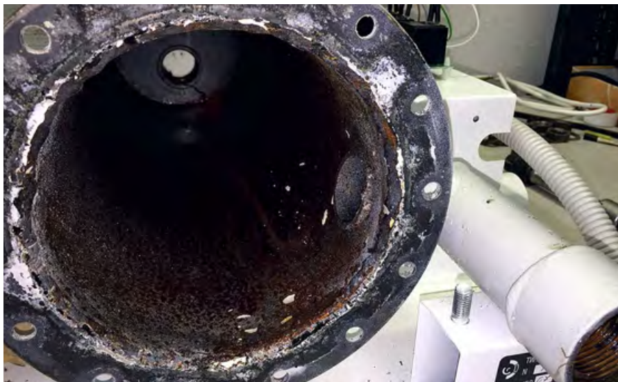
❖ Фото 1. Теплообменник отопительного котла после месяца работы на «метанольном коктейле»
