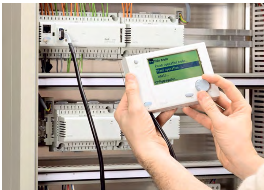
❖ Шкаф управления ИТП на базе контроллеров Synco
