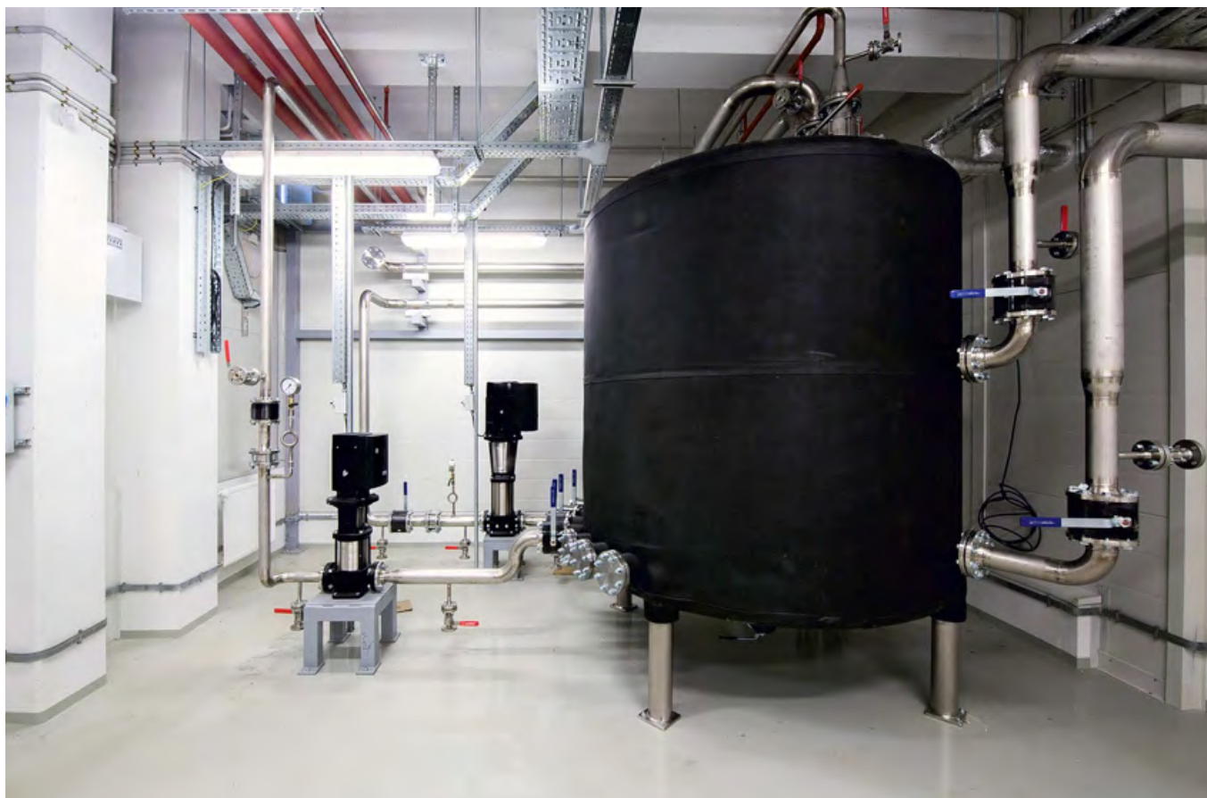
❖ Вертикальные многоступенчатые насосы Grundfos CRE на российском заводе производителя лакокрасочной продукции Текнос
