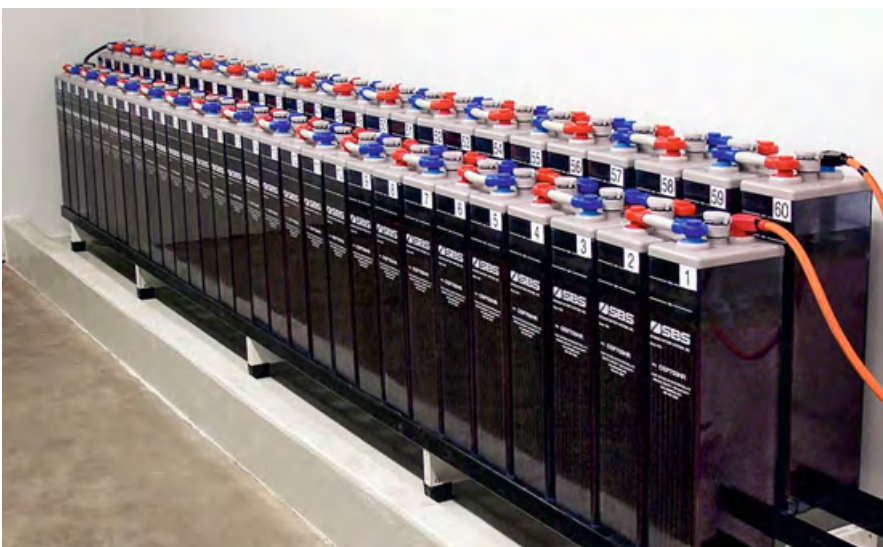
Пример комплекта аккумуляторных батарей
