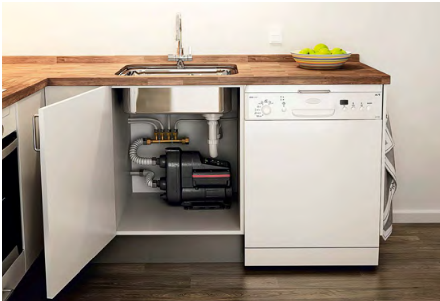
∴ Насосная установка SCALA2 в кухне
