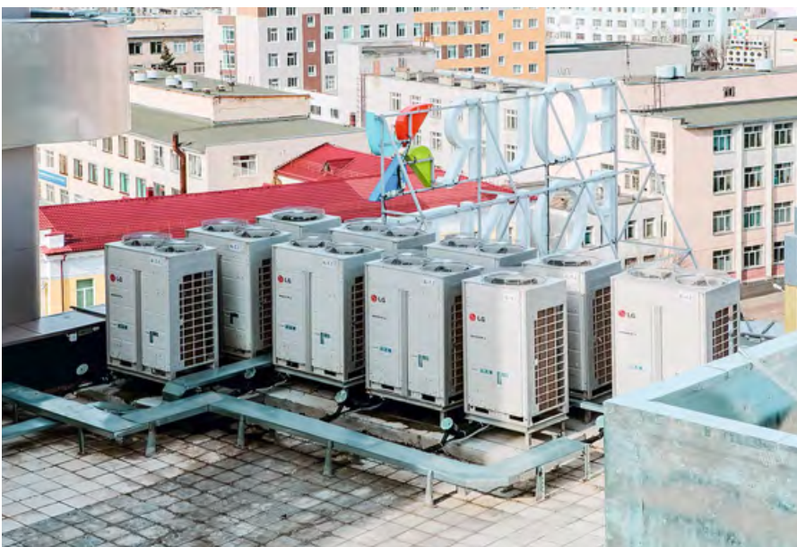
Внешние блоки мультizonальной системы Multi V IV на крыше отеля Four points by Sheraton
