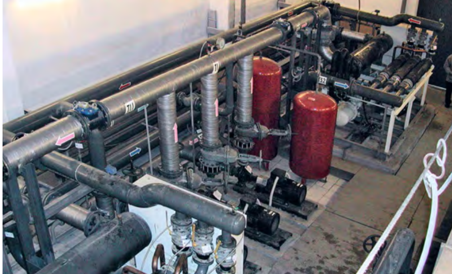
❖ Фото 1. Теплонасосный тепловой пункт (машинный зал)
