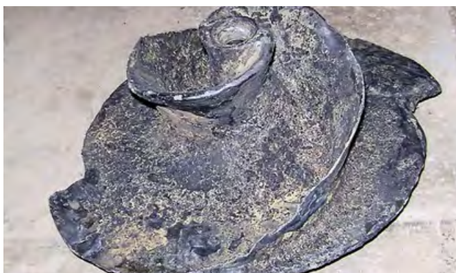
•• Фото 6. Изношенное рабочее колесо фекального насоса Flygt
