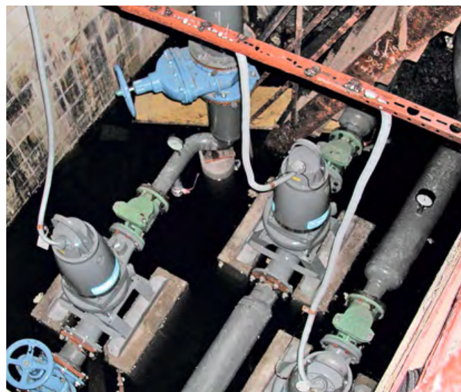
❖ Фото 3. Группа из трёх подающих фекальных насосов в здании ГКС
