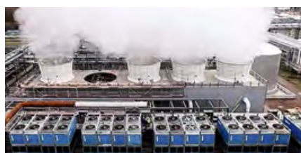
❖ Фото 3. Временный хладоцентр, развёрнутый на период ремонта штатной градирни
