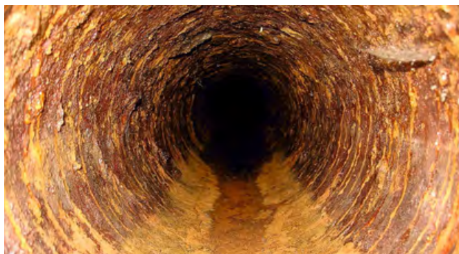
•• Фото 7. Отложения на поверхности теплообменника-утилизатора
