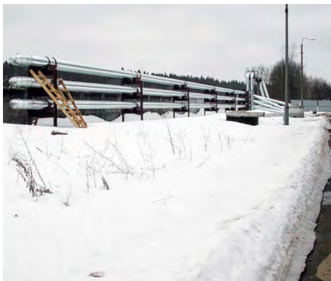
❖ Фото 2. Теплообменник-утилизатор на площадке возле здания ГКС
