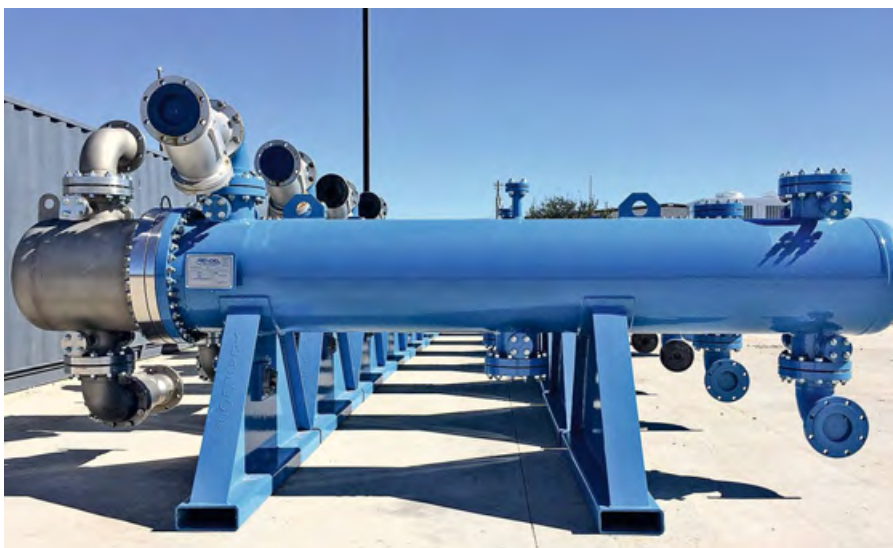
❖ Фото 5. Теплообменник, использующийся для охлаждения нефтепродуктов и подключаемый по временной схеме
