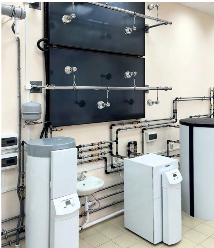
● ● Фото 2. Гелиоустановка, тепловой насос и аккумулятор тепла
