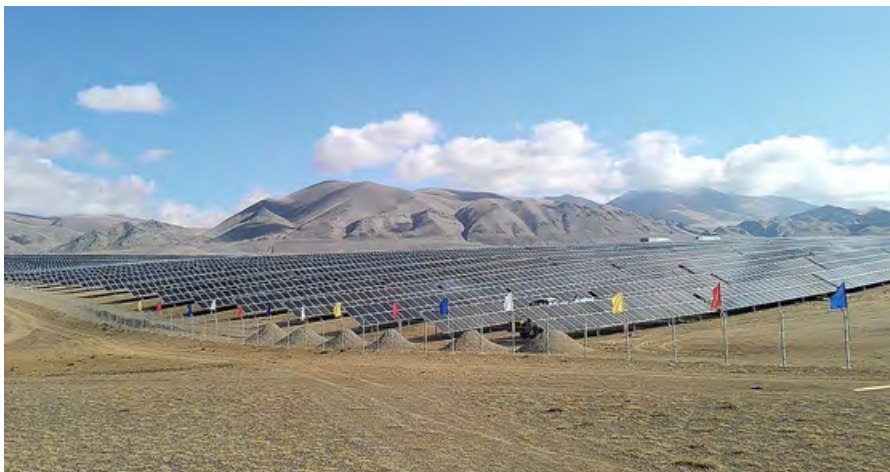
●● Кош-Агачская солнечная электростанция (село Кош-Агач, Республика Алтай)
