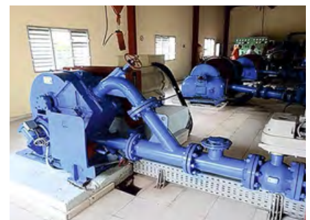
●● Гидроагрегат К200 мощностью 200 кВт микро-ГЭС Pico Blanco (Куба, 2014 год)
