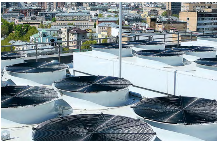
❖ Фото 1. Размещение драйкулеров на крыше одного из зданий
