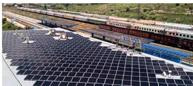
●● Солнечная энергоустановка на крыше железнодорожного вокзала города Анапа для ОАО «РЖД» (мощность установки 70 кВт)
