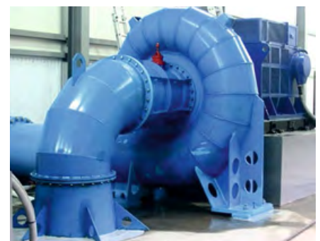
●● Гидроагрегат микро-ГЭС «Фаснал» (Россия), установлено три агрегата ГА9 мощностью по 1600 кВт и один агрегат ГА10М
