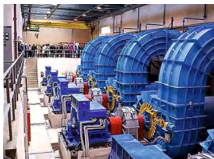
●● Машинный зал микро-ГЭС «Ляскеля» (Нарвья), установлены шесть гидроагрегатов ГА8М мощностью по 800 кВт
