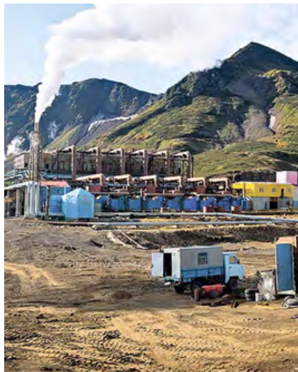
Мутновская ГеоЭС 50 (2×25) МВт (введена в эксплуатацию в 2002 году)
