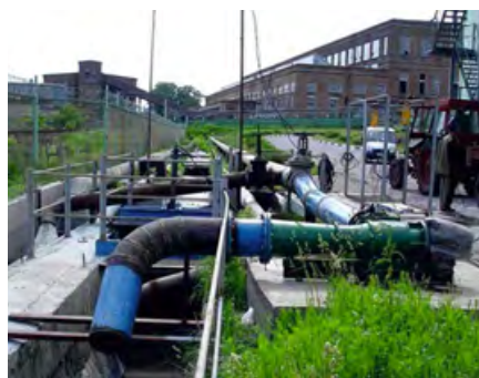
●● Микро-ГЭС мощностью 7–9 кВт на сливе оборотной воды горнодобывающего комбината (введена в 2012 году)
