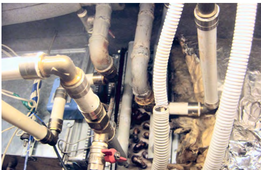
❖ Фото 3. Узел подсоединения калорифера
