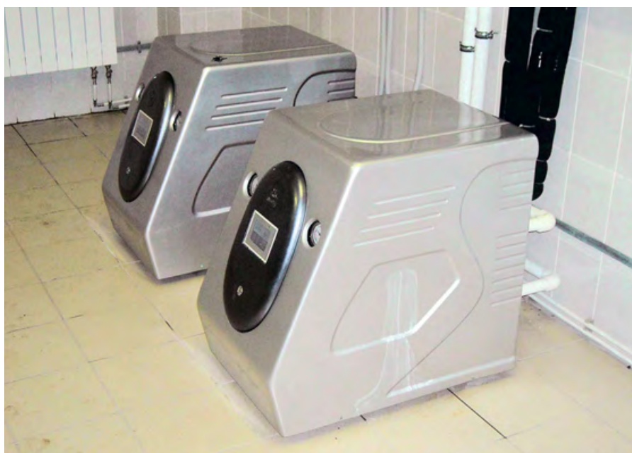
❖ Помещение водоподготовки бассейна Самарского государственного университета
