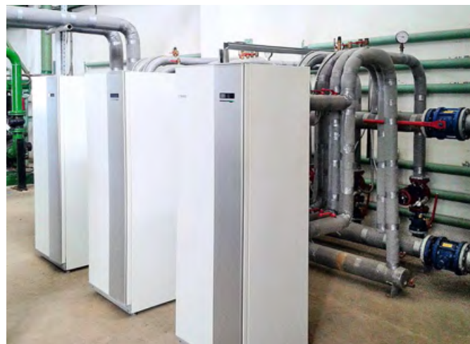
❖ Тепловые насосы и теплообменники забора тепла от водовода
