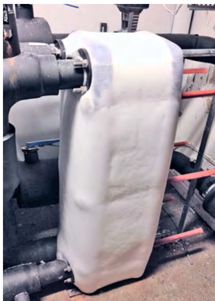
❖ Теплообменник (предназначен для охлаждения льда в ледовом дворце Löfbergs Arena)
