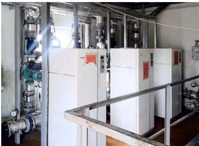
❖ Каскад тепловых насосов 4 × 60 кВт для подогрева нефти
