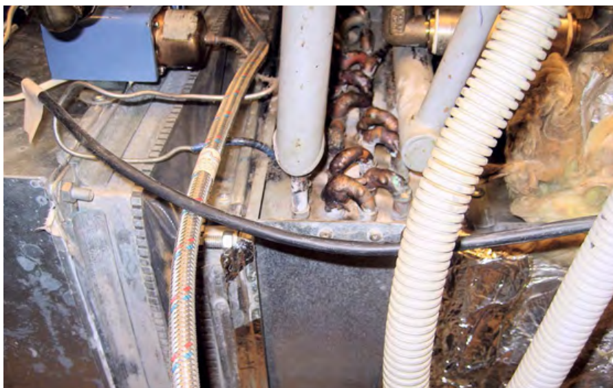
❖ Фото 5. Неправильный монтаж термостата
