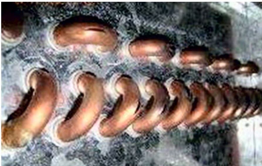
•• Фото 4. Вид калорифера после аварии с разрывами трубок
