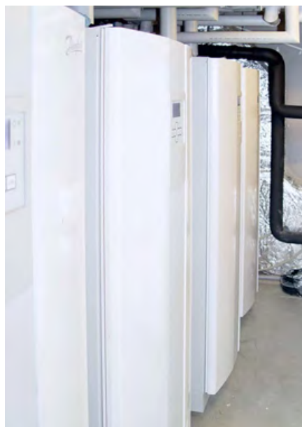
❖ Каскад тепловых насосов, установленный в ледовом дворце Löfbergs Arena
