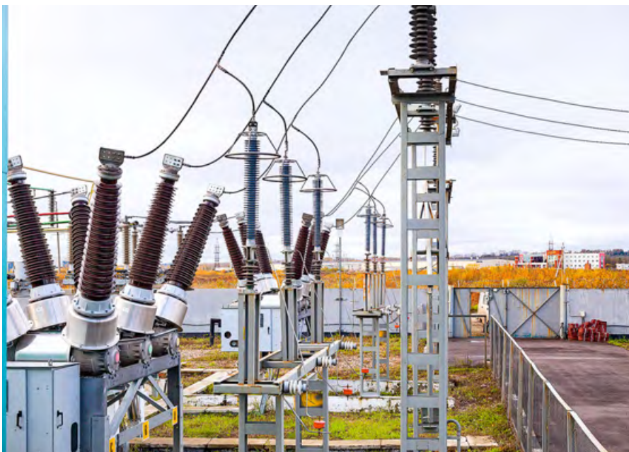
Подстанция 110 кВ «Чайка» компании «Ярэнерго» (филиала ОАО «МРСК Центр»)
