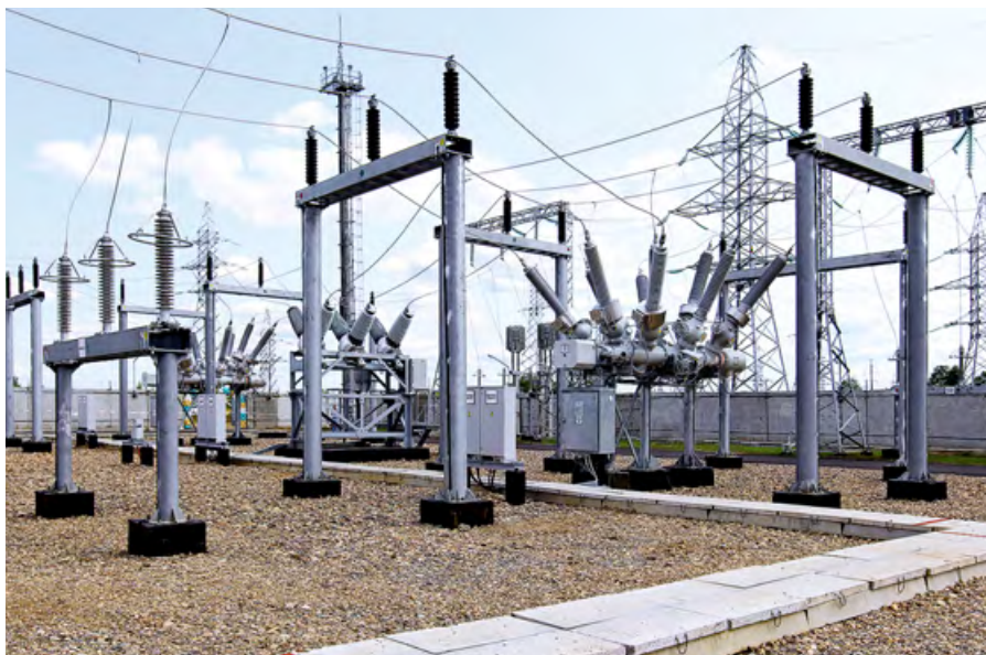
❖ Подстанция 110/10 кВ «Новосёлки»
