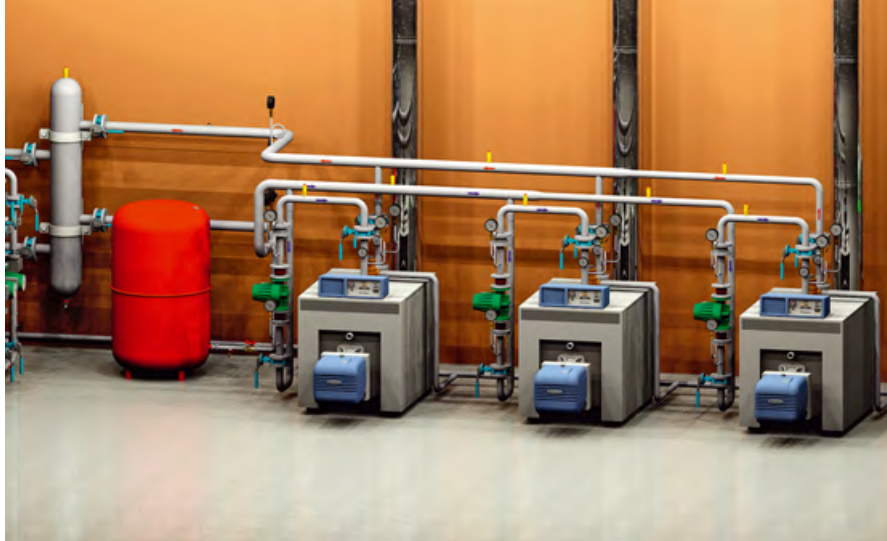
❖ Рис. 1. Рассматриваемая котельная из трех котлов
