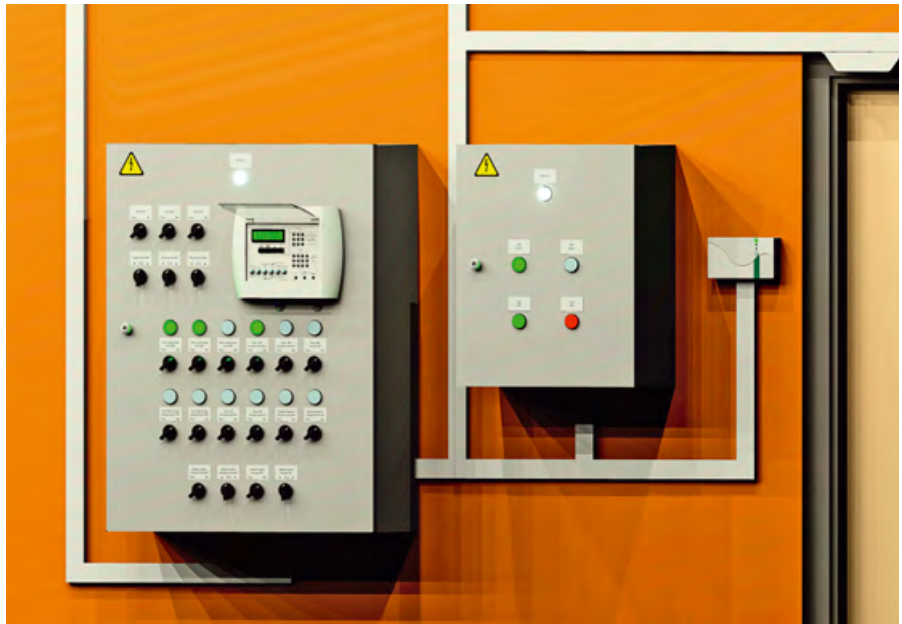
•• Рис. 3. Щиты автоматики АТМ (тепломеханической части) и АГСВ (внутреннего газоснабжения)
