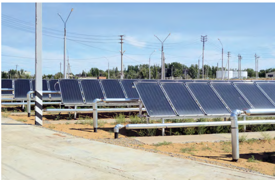
☀ Котельная на базе 2200 солнечных коллекторов Buderus в Нариманове (Астраханская область)
