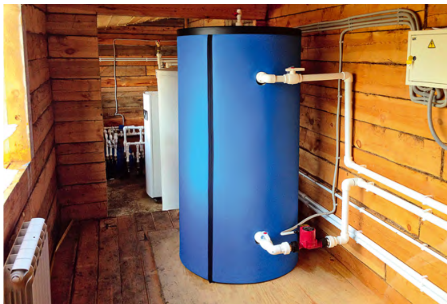
☀ Котельная мощностью 14 кВт в поселке Курма (Ольхонский район Иркутской области)
