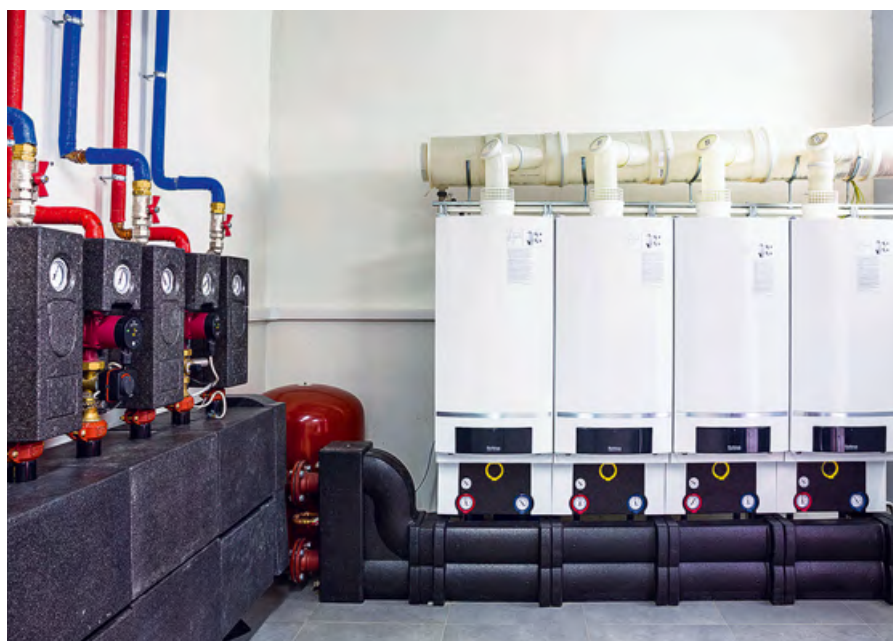
❖ В городе Пушкино (Московская область) открылся новый автосалон Nissan: в котельной мощностью 356 кВт/м 2 на площади 1 м 2 установлено сразу четыре конденсационных котла Buderus Logamax GB 162, расположенных в каскаде
