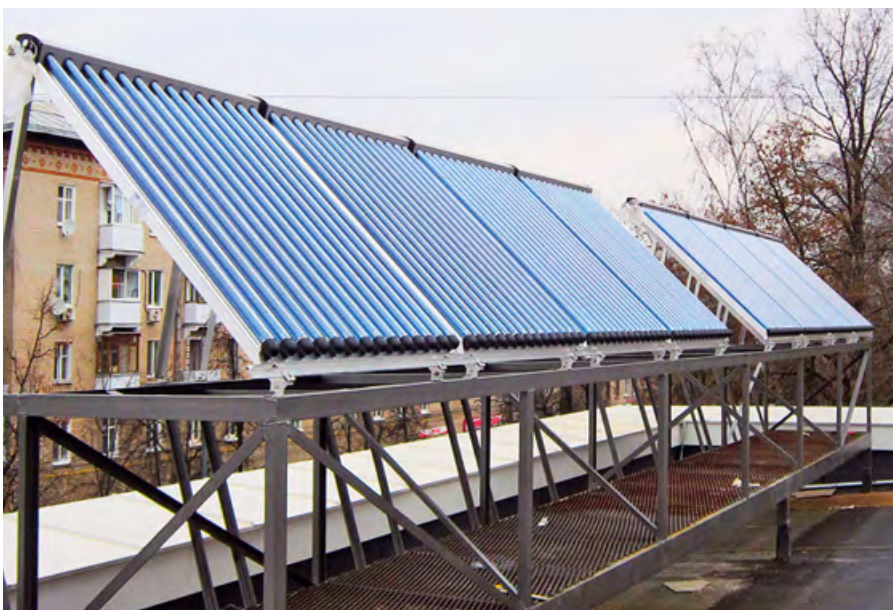
•• Восемь солнечных коллекторов вакуумного типа Meibes на крыше здания
