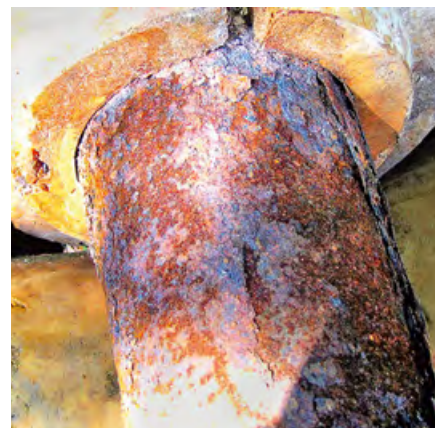
❖ Фото 1. Поврежденная поверхность трубы
