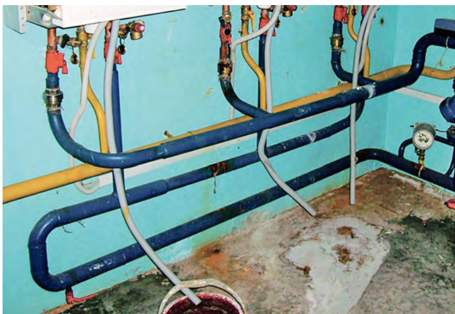
❖ Слив конденсата из конденсационного котла
