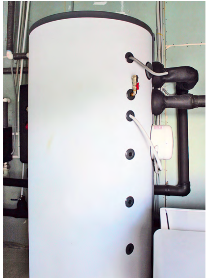
❖ Фото 11. Смонтированный емкостной бойлер SBB 751 WP
