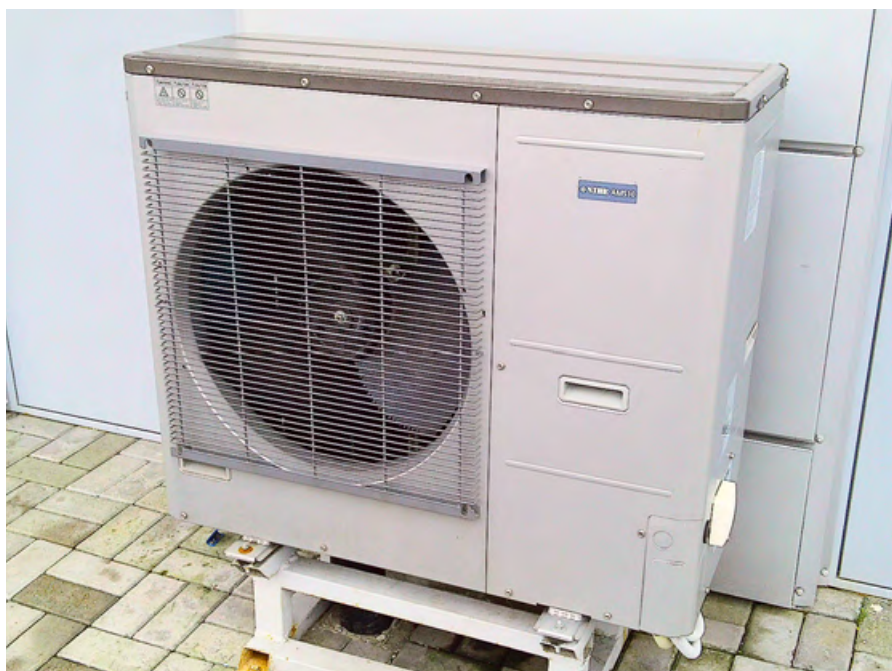
❖ Фото 1. Воздушный ТН использован при модернизации дизельной котельной на АЗС в городе Калининграде
