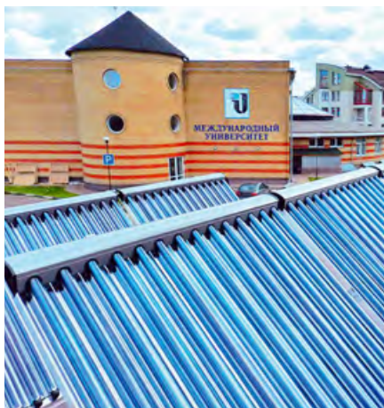
❖ Вакуумные солнечные коллекторы на крыше ИТП в поселке Заречье
