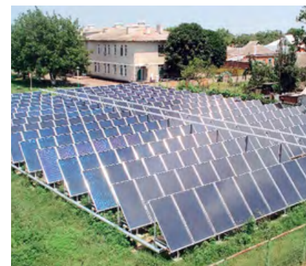
Фото 1. Гелиоустановка большого здания в городе Усть-Лабинске
