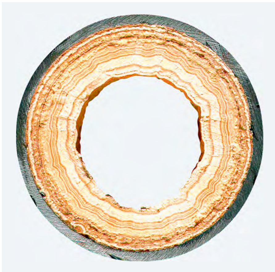
⌘ Рис. 1. Образование отложений на внутренней поверхности трубопровода
