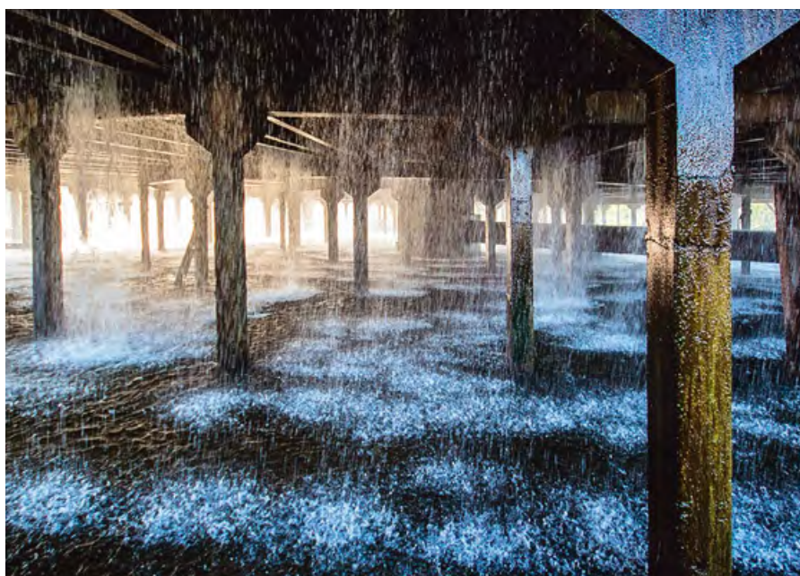
❖ Фото 1. Водные потоки внутри градирни в ее «подоросительном» пространстве
