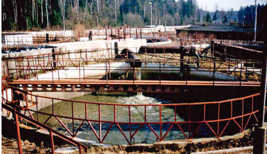
:: Фото 1. Регулирующие резервуары очистных сооружений города Краснознаменска
