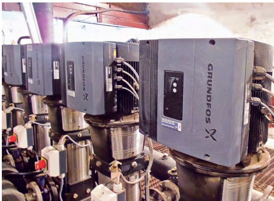
❖ Насосная станция Hydro MPC-E, установленная на мясокомбинате «Кунгурский»
