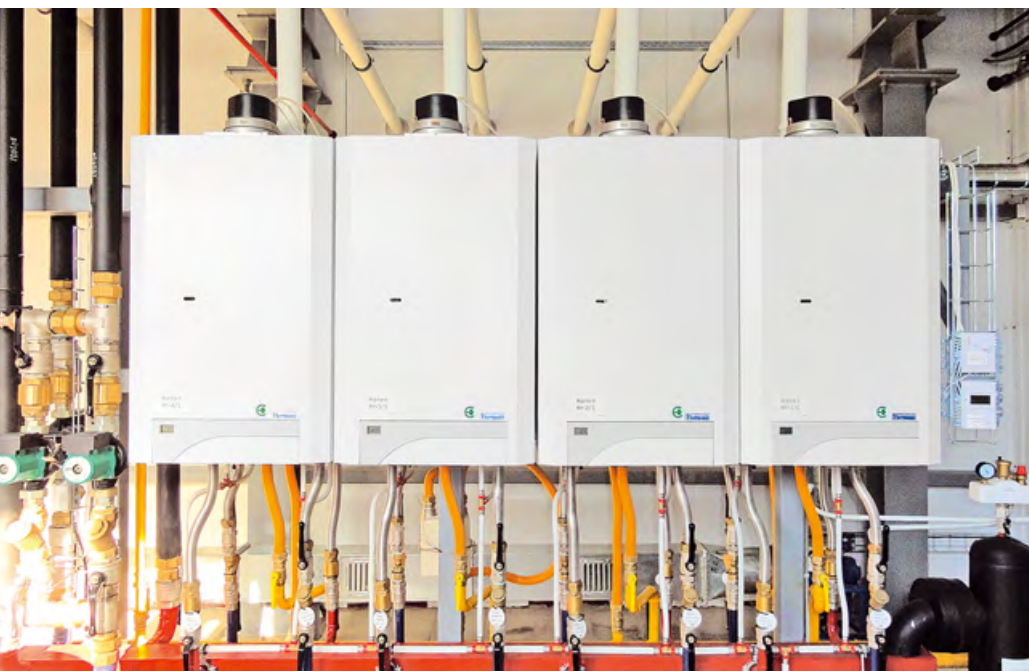
❖ Фото 2. Каскадная котельная, принадлежащая Зарайской районной эксплуатационной службе (РЭС) ГУП МО «Мособлгаз» на базе котлов Thermona Duo 50 FT
