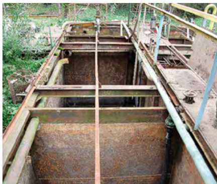
:: Фото 2. Блок сооружений биологической очистки сточных вод поселка Горки-2
