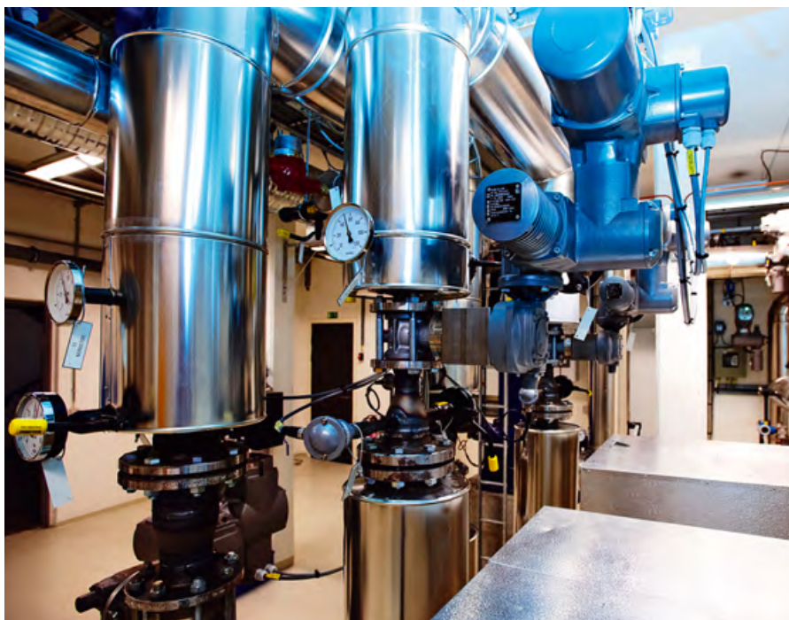
⇨ Перекачивающая насосная станция «Фортум»
