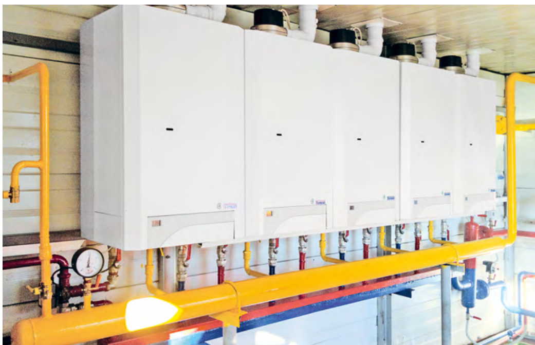
❖ Фото 1. Каскадная система малых газовых котлов
