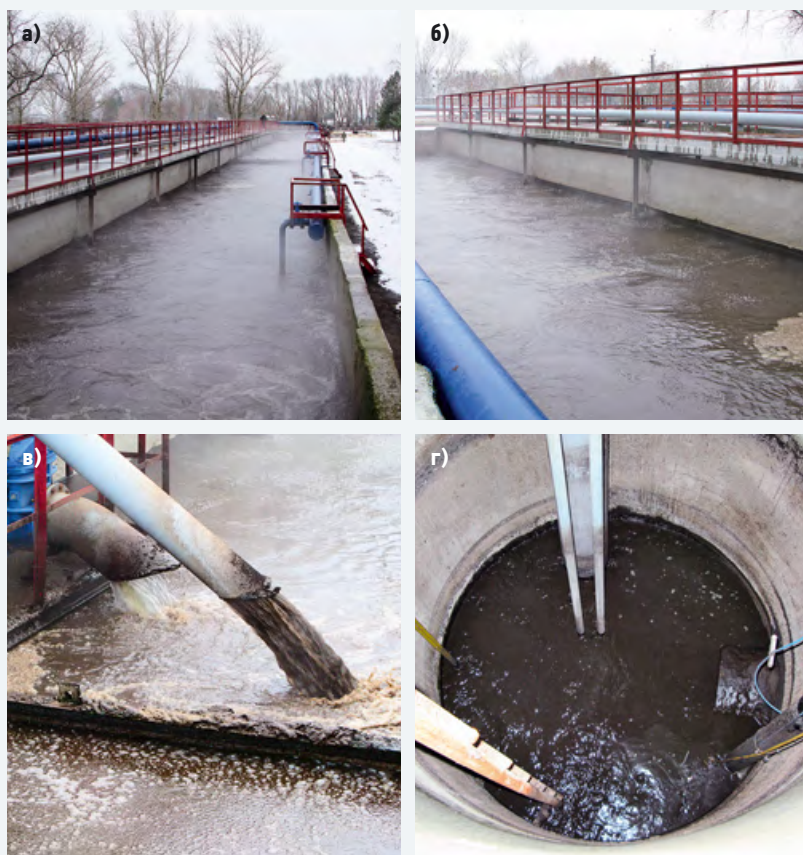
❖ Фото 5. Аэротенк с одноиловой системой денитри-нитрификации и иловая насосная станция после аэротенка в эксплуатацию [а — зона (аноксидная) денитрификации; б — зона нитрификации; в — подача сточной воды и рециркуляционного активного ила в зоны денитрификации; г — иловая насосная станция]
