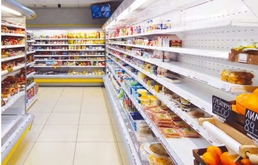
❖ Фото 2. В торговом зале супермаркета установлено девять единиц холодильного оборудования
