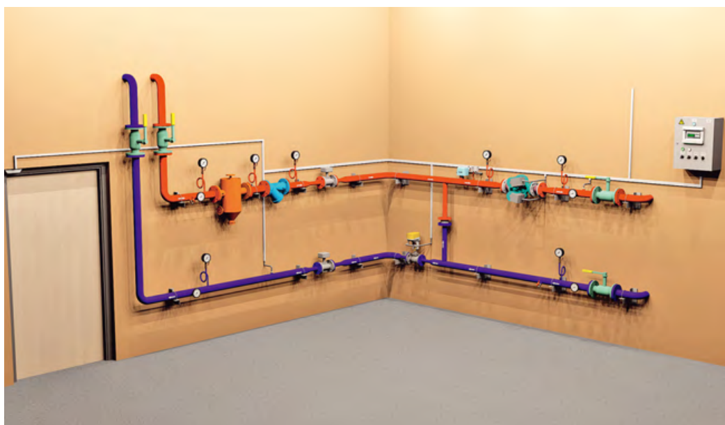
⊞ Фото 1. Тепловой пункт с погодозависимым управлением температурой теплоносителя и сдвоенным насосом циркуляции
