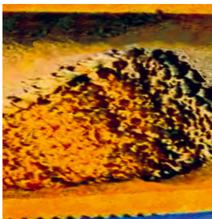
⚡ Фото 4. Кавитационное разрушение внутренней поверхности сгона перед клапаном
