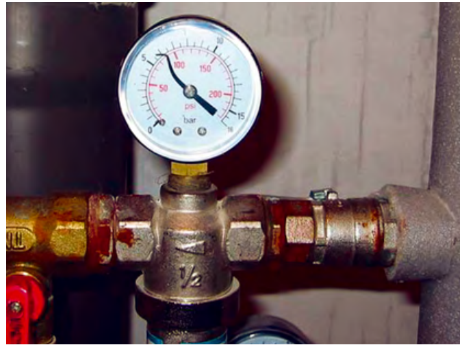
Фото 2. Характерное повреждение манометра гидравлическим ударом в системе
