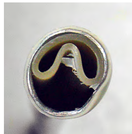
⚡ Фото 6. «Схлопнувшаяся» от гидроудара металлополимерная труба
