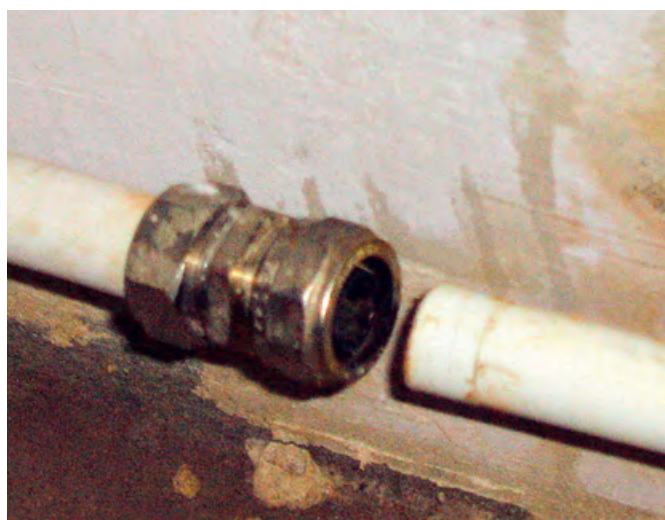
⚡ Фото 3. Нарушение обжимного соединения МПТ в результате воздействия гидроударов
