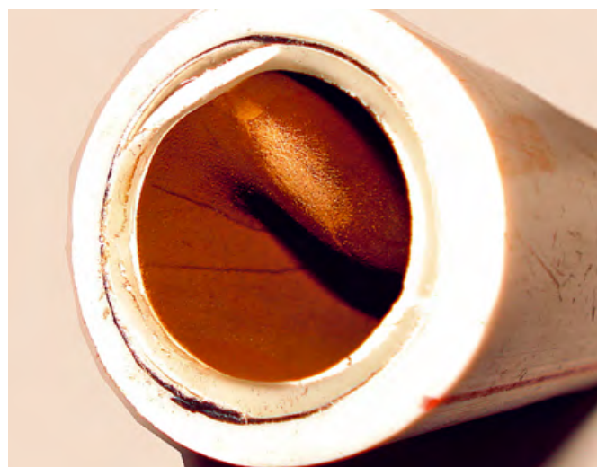
⚡ Фото 5. Многослойная полипропиленовая труба, пострадавшая от гидравлического удара
